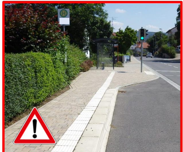
Abb. 28: Der Leitstreifen ist – von der Straßenquerung kommend – gefährlich nah an den Bordsteinrand gebaut worden. Zwischen Bordsteinkante und Leitstreifen muss ein Abstand von mindestens 60 cm vorgesehen werden.
