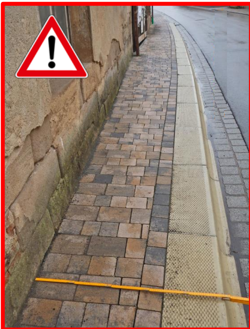
Abb. 29: Trotz 18 cm-Hochbord mit Spurführung ist an dieser Haltestelle bei nur 1 m Gehwegbreite keine Barrierefreiheit gegeben: keine ausreichende Rangierfläche für Rollstuhlfahrer und sehr schmale Zuwegung.
