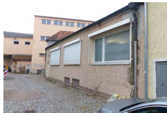
Rückseiten, Gestaltungsdefizit / Erhaltungsmängel (Glasergasse)
