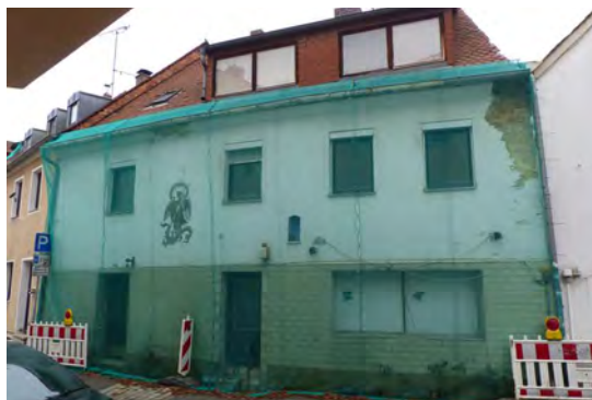
schlechter Gebäudezustand (Glasergasse)
